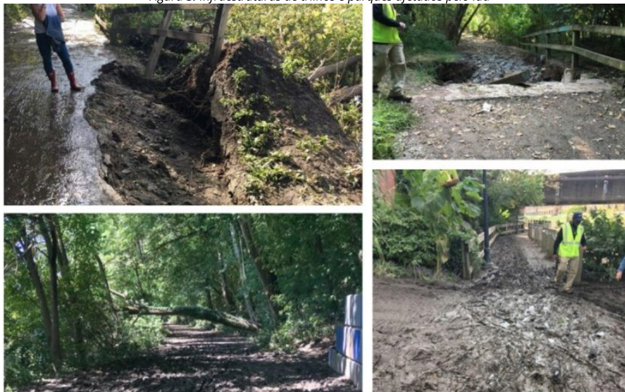
Figura 3: Infraestruturas de trilhos e parques afetados pelo Ida
