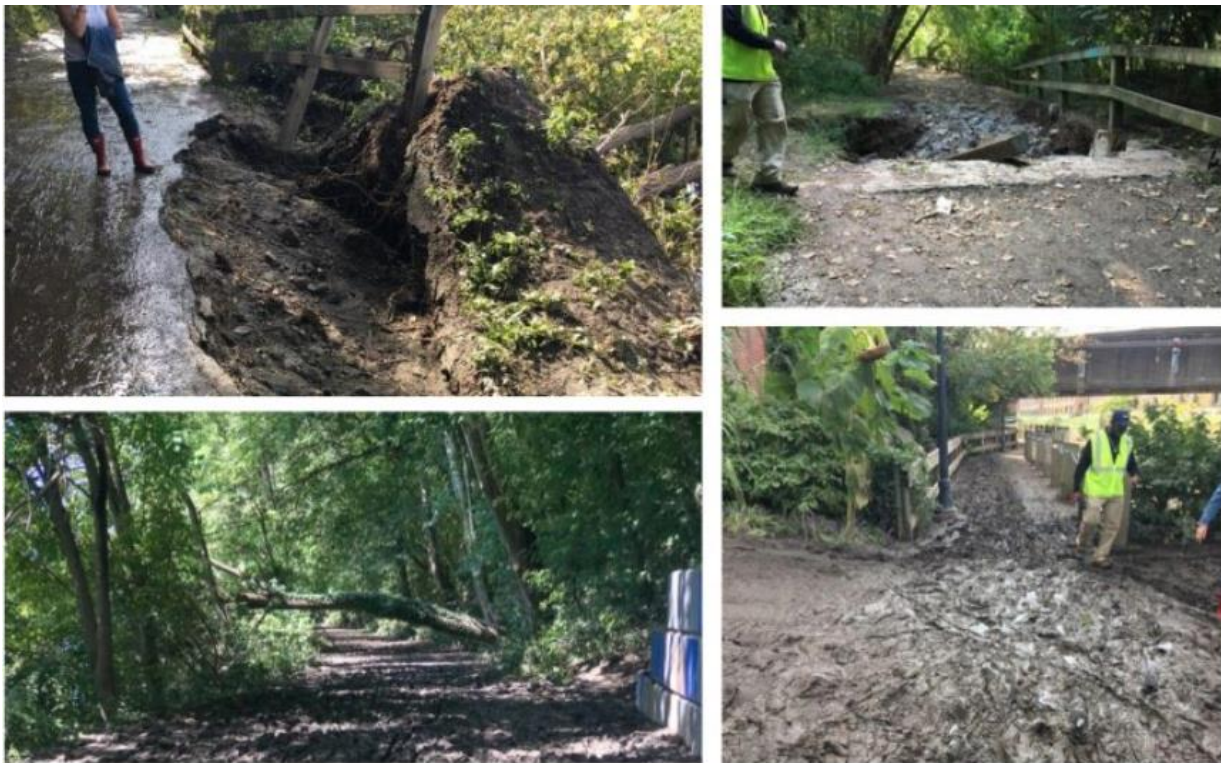
Imagen 1-3: Infraestructuras de parques y senderos afectadas
